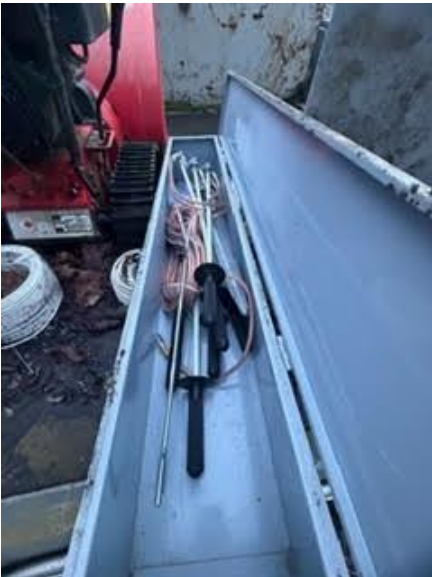
Messa a terra BT
